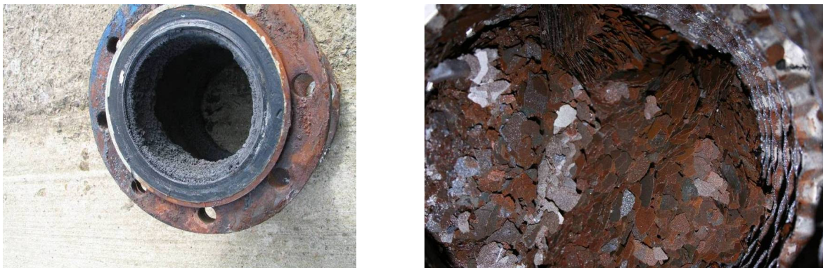
Abb. 3 Typische Scales aus der Anlage Neustadt-Glewe: graue Beläge in einem Flansch der Förderbohrung (links) sowie rostig-plattige Ablagerungen im Zulauf eines Plattenwärmetauschers (rechts)
